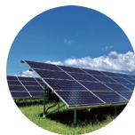
太陽光発電設備
